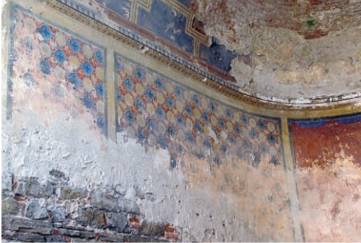
Pozostałości starych malowideł przed remontem
