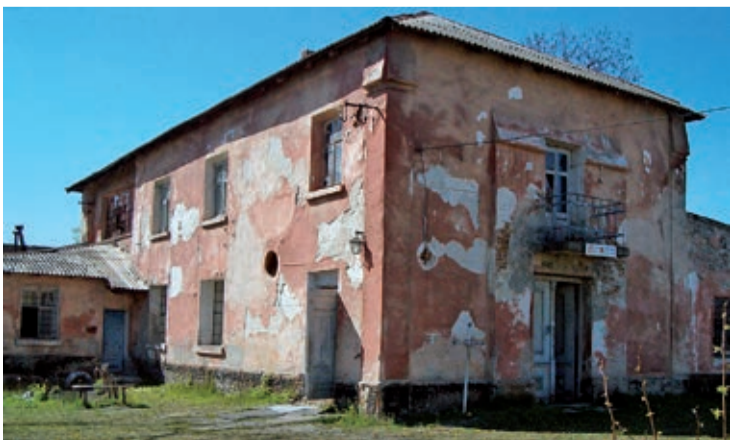
WIELKIE MOSTY, KOŚCIÓŁ PRZED ODDANIEM W STANIE RUINY. STAN 2007
